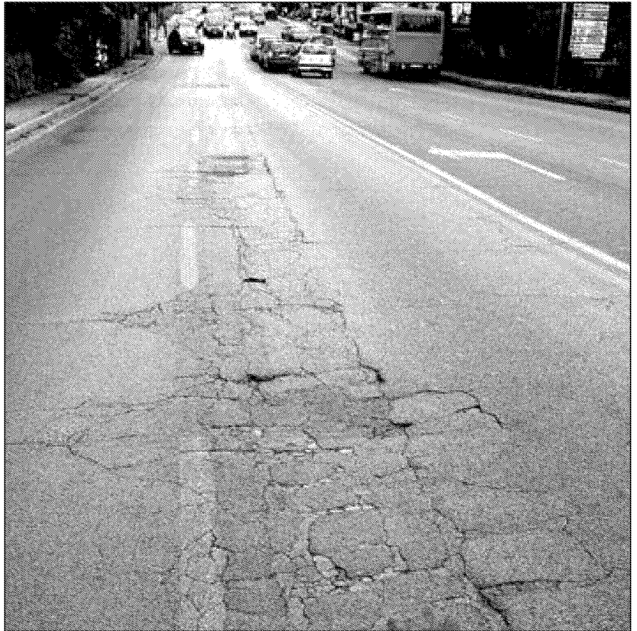
Manto stradale dissestato Alcune fra le buche incrinature e che sono diventate oggetto di polemica fra il Comune e i cittadini (foto P)
