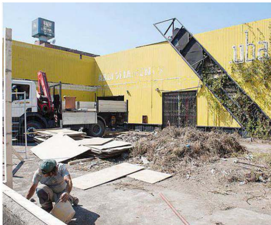
Sono cominciati i primi lavori nell'edificio ormai fatiscente dell'Uba Uba (foto Sernacchioli)
